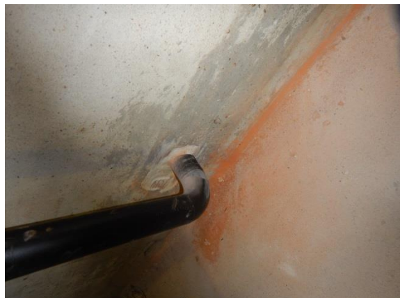
4. Rør fra olietanke indført gennem væg.
