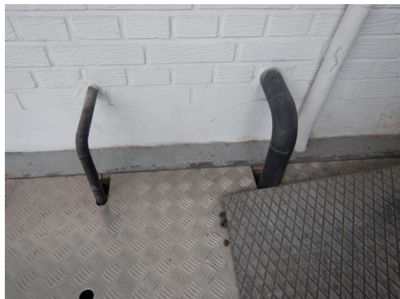
6. Rør fra olietanke set fra den anden side.
