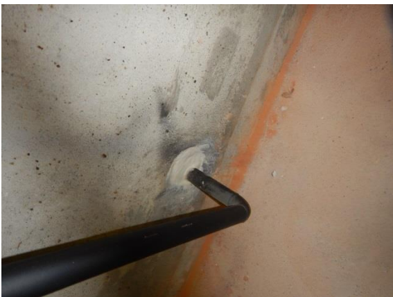
3. Rør fra olietanke indført gennem væg.
