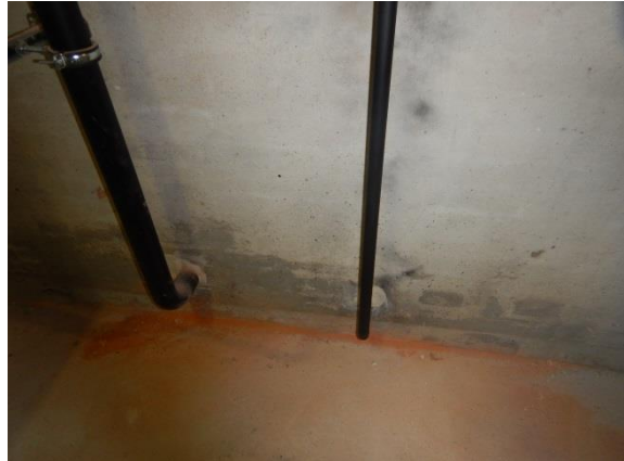
2. Rør fra olietanke indført gennem væg.
