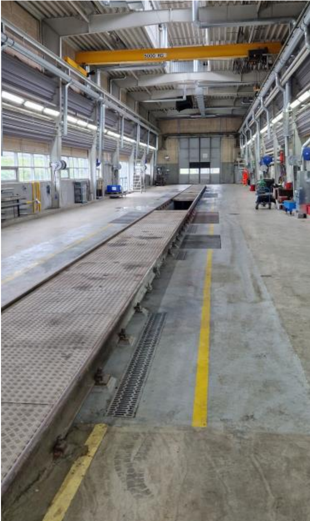
Hallen til graffiti fjernelse. Alle afløb er afproppede, således at spildevand opsamles og pumpes til internt renselanlæg.
