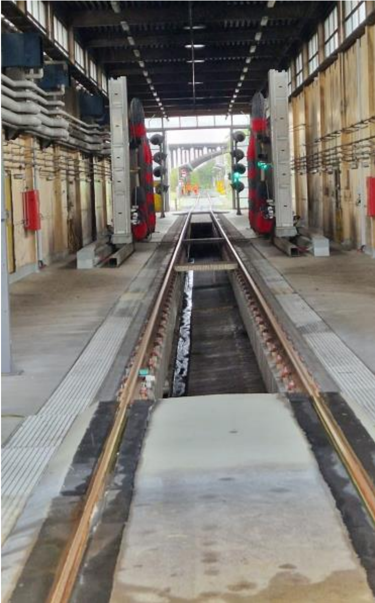
Vaskehal til togvask. Vask foretages på sider og front med roterende vaskebørster.
