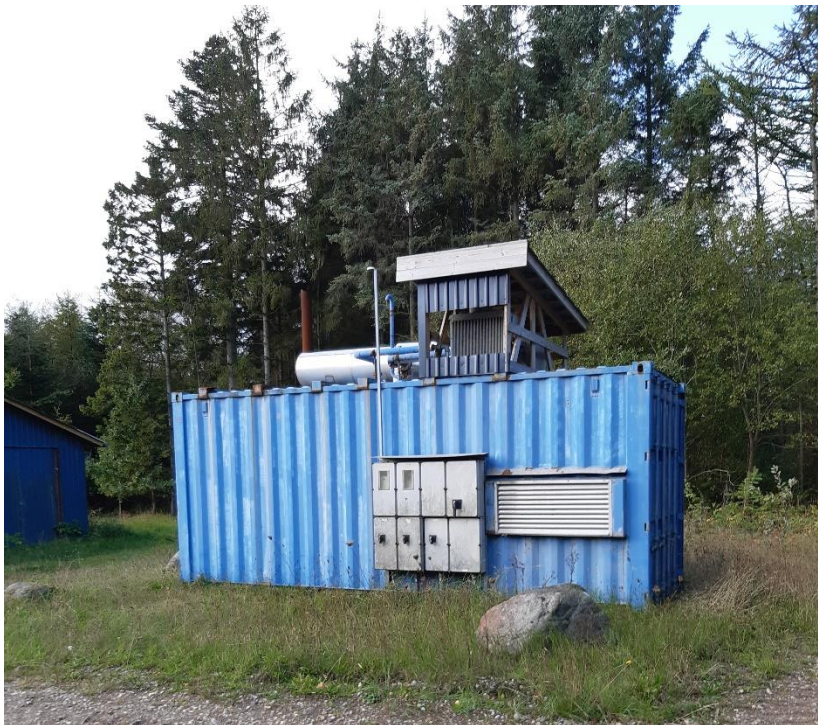
Billede 6 - Container med gasmotor.
