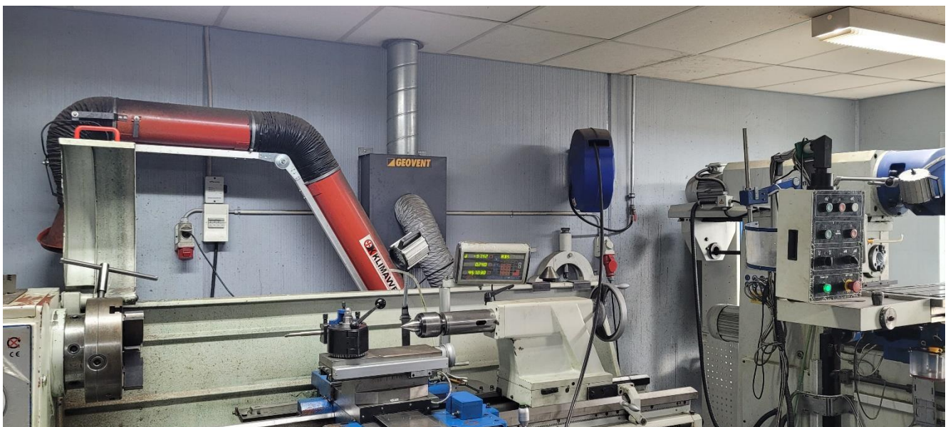
Udsugning ved spåntagende forarbejdning med tilhørende olietågefilter.
