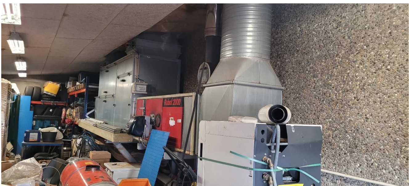
Genvex anlæg til komfortventilation af værkstedshal.
