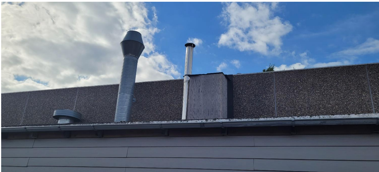
Luftafkast fra udsugningsanlæg og skorsten fra oliefyr.
