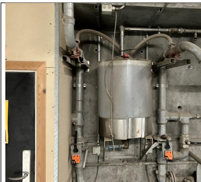
Foto 4: Skumstation med beholder til brandslukningsskum.
