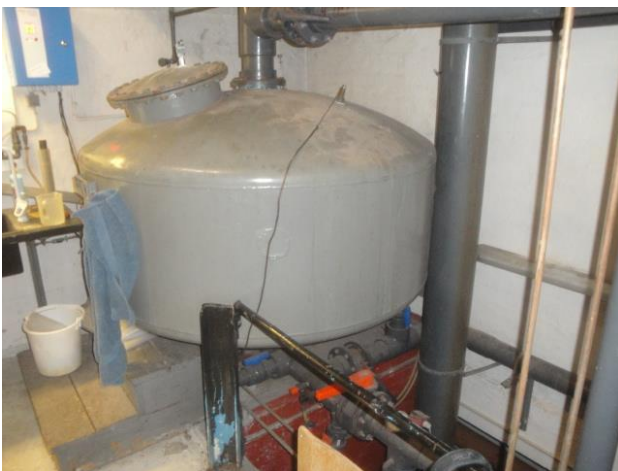
Sandfiltret ved Rugvænget Skoles svømmeanlæg.
