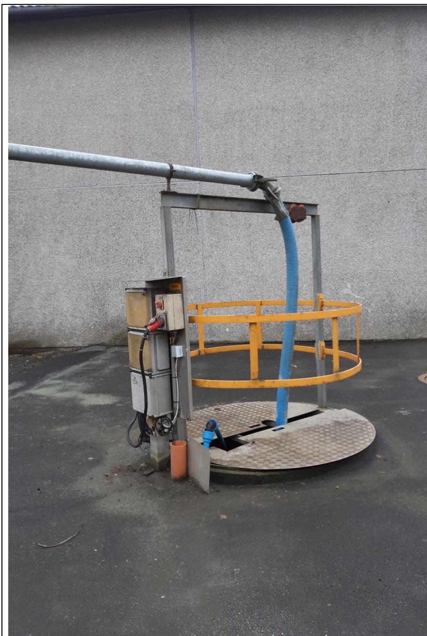
Pumpebrønd med opsamlet overfladevand. Vandet pumpes til betontank.
