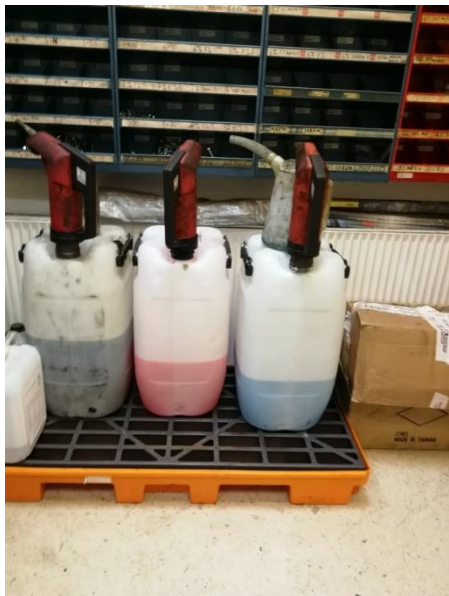
Billede 4. Opsamlingskapacitet under dunke med kølervæske og sprinklervæske.
