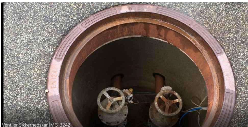
Stilbillede; Ventiler er åbne inden der tilføres vejsalt til afløbet.
