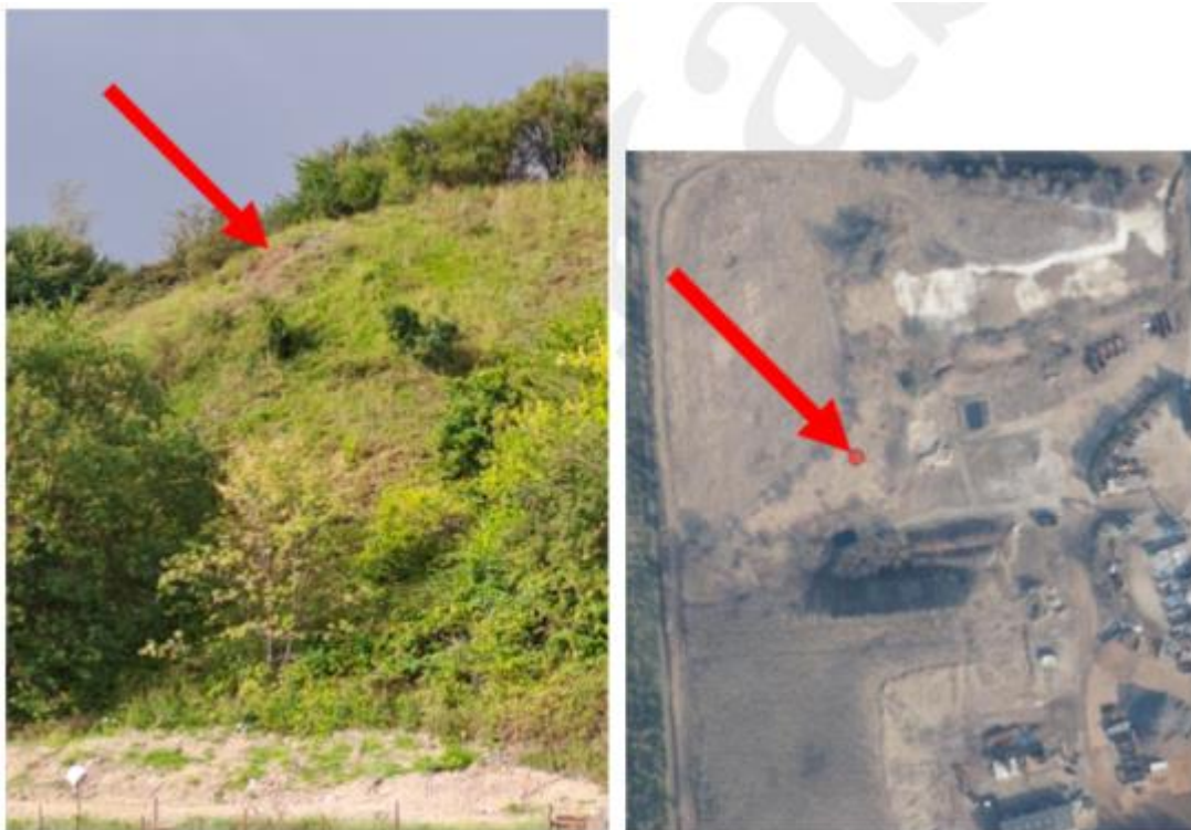
Billede 2. Skred i slutafdækning pga. dyrevildt, venstre foto. Lokalisering af skred på luftfoto, højre foto.
