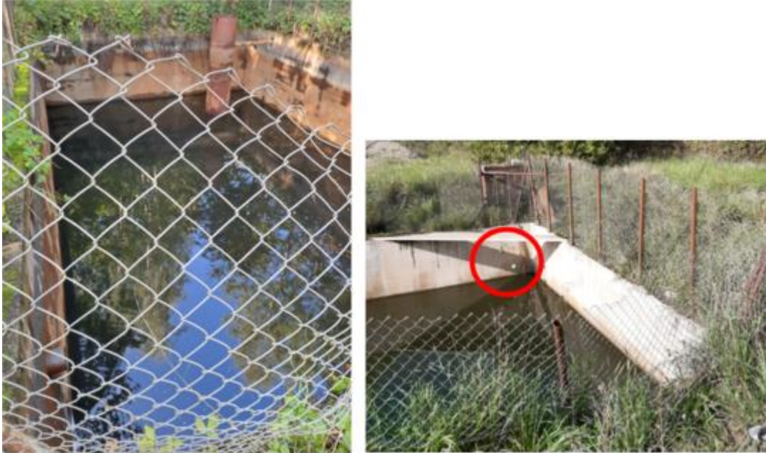
Billede 6. Perkolatbassin 1, til venstre, og perkolatbassin 2, til højre, med markering af niveaufølere til fyldningsalarm.
