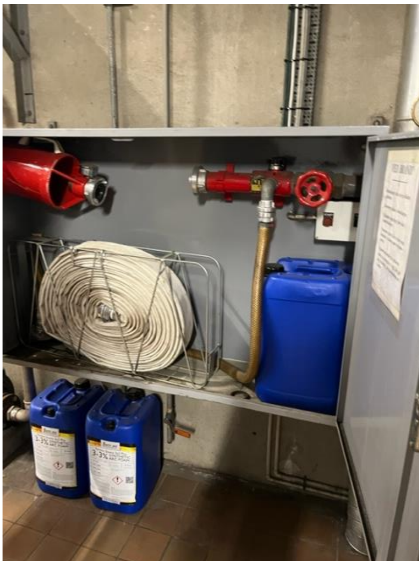
Foto 4: Brandskab med brandslukningsudstyr og dunke med brandskum i oplag under skabet.
