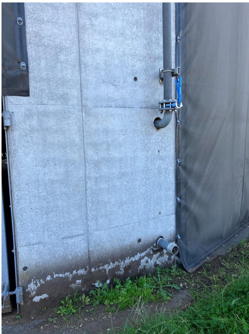
Foto 2: Tilkoblingssted til stigrør på træflissilo.
