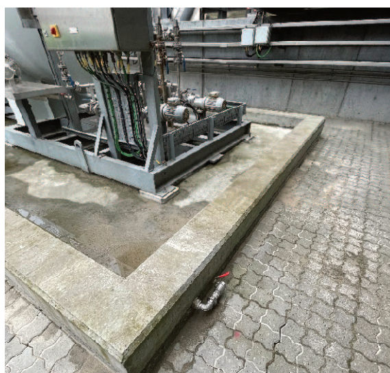
Ventil til afledning af regnvand fra spildopsamling
