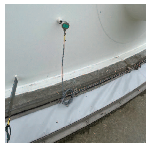
Termoføler i tank
