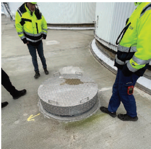
Inspektionsbrønd til kontrol af tankbundes tæthed
