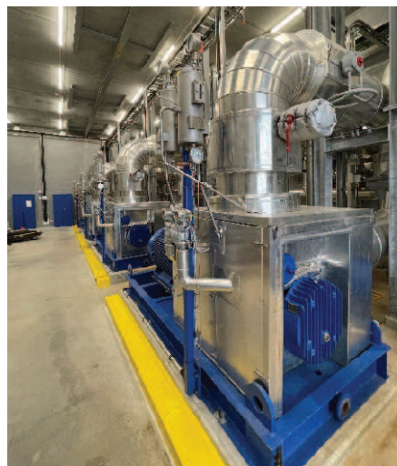
Pumperum, fire motorer til tankanlæg
