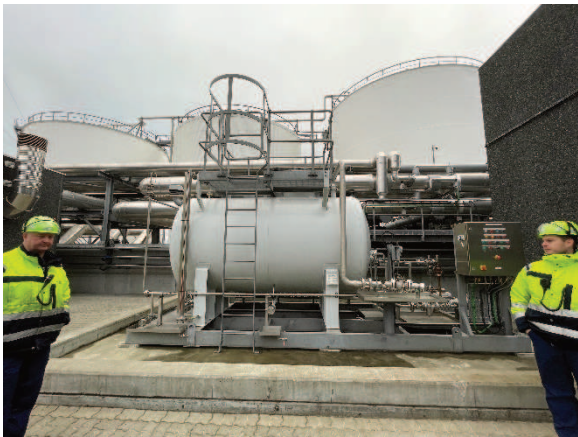
Tank til farveadditiv, er ikke taget i brug endnu
