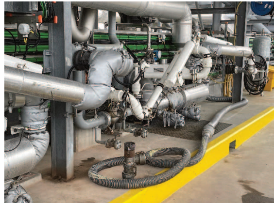
Vapour-slange ved læsserampe
