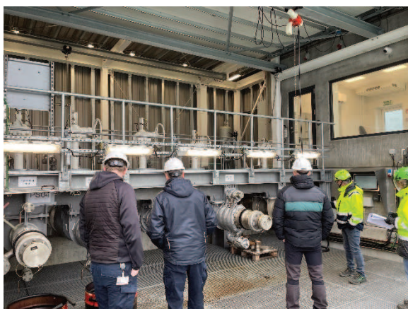
BLF platform, spildopsamling i tank under gitterrist
