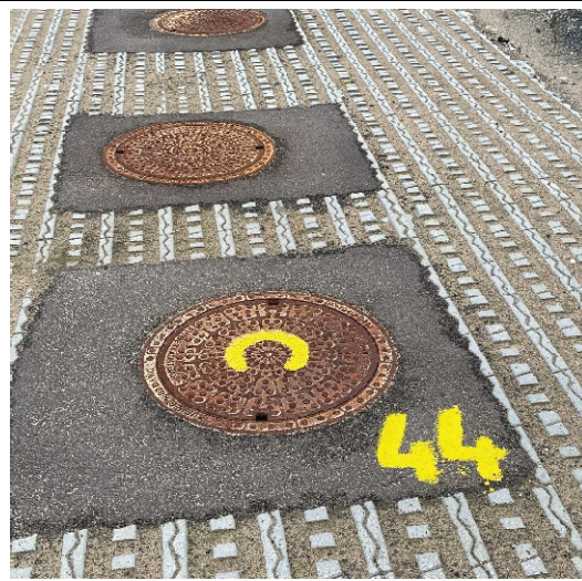
Mærkning af brønde og olieudskillere
