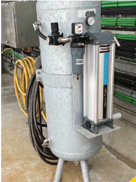
Kulfilter ved læsserampe
