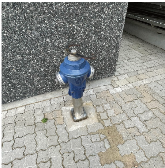
Én ud af to brandhaner på anlægget
