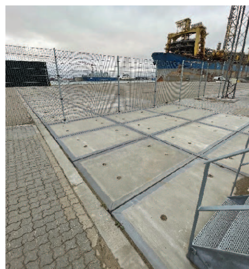
Overdækkede rørledninger til BLF
