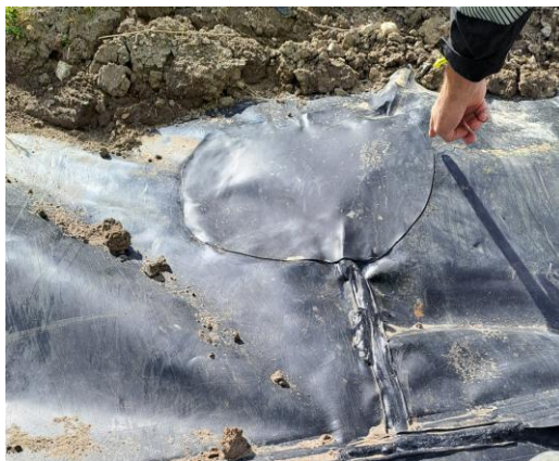
Billede 5. Der er en del huller i membranen som er blevet lappet. Både svejsesømme og lapper tæthedstestes.
