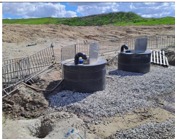
Billed 7. Perkolatbrønde uden for enheden.
