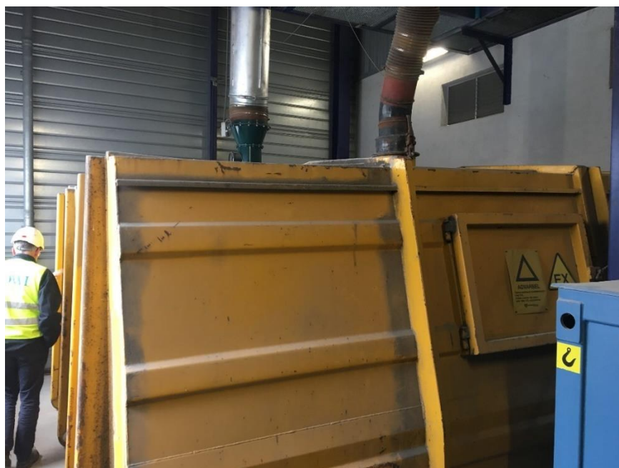
Figur 2-5 Vakuumcontainer til centralstøvsugeranlæg.
