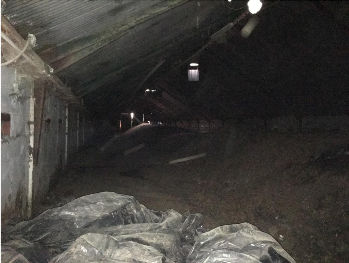
Sydlig ende – uafdækket gødning og 3 ikke lukkede tagafkast
