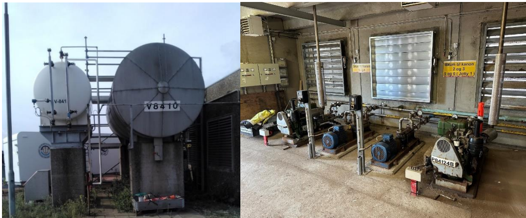
Foto 3: Oplag af brandskum og diesel i ståltanke tv. Brandpumper i brandpumpehus th.
