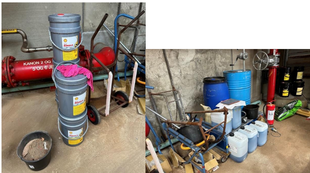
Foto 5: Kemikalieoplag i brandpumpehuset.
