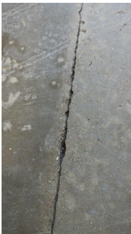
Billede 3 – revner i beton i grageanlæg
