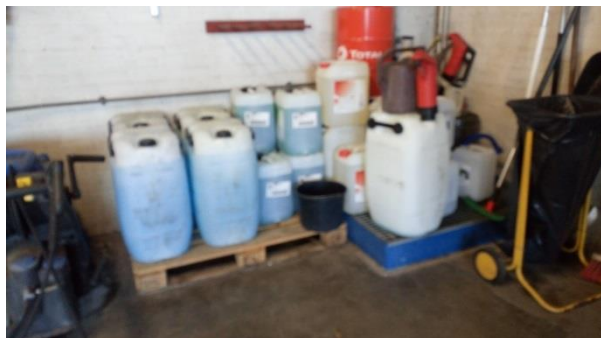
Billede 1 – oplag af sprinklervæske uden spildbakke i garage med afløb
