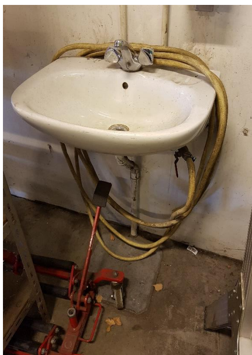
Lukket gulv afløb
