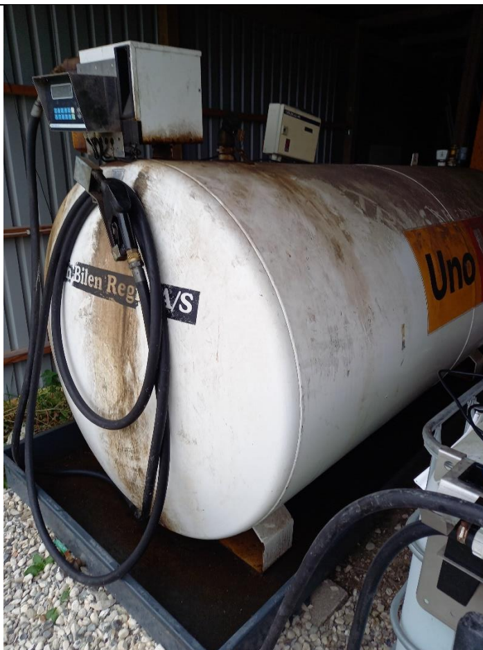
Billede 3. Dieseltank i spildbakke.
