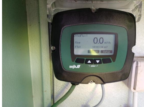
Deponi II. Flowmåler for perkolat samlebrønd (H)
