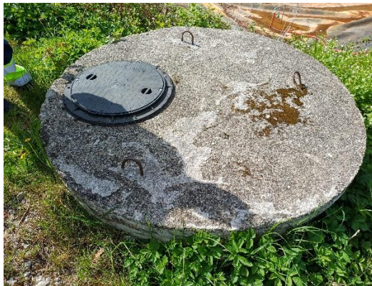
Deponi III. Gennemløbsbrønd inden pumpen
