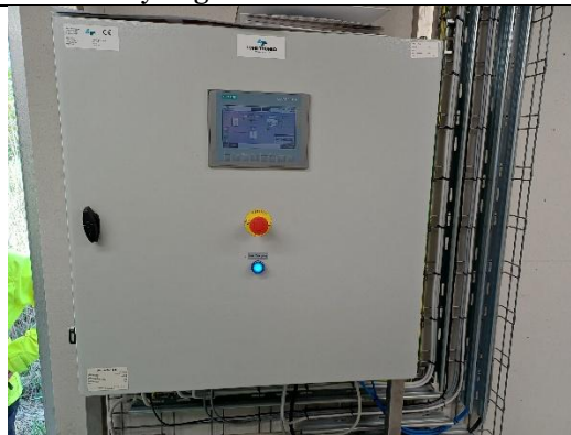
Deponi III. Overvågning for biocover/gas. Dette overvåges og styres af NIRAS da det er del af biocover ordning.
