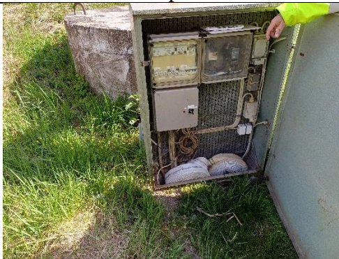
Deponi III. Kig i elskab til pumpebrønd G, Det er Kryger/Viola, der har lagt slanger, hvis der er behov for manuel pumpning mellem brønde bassin eller lign.
