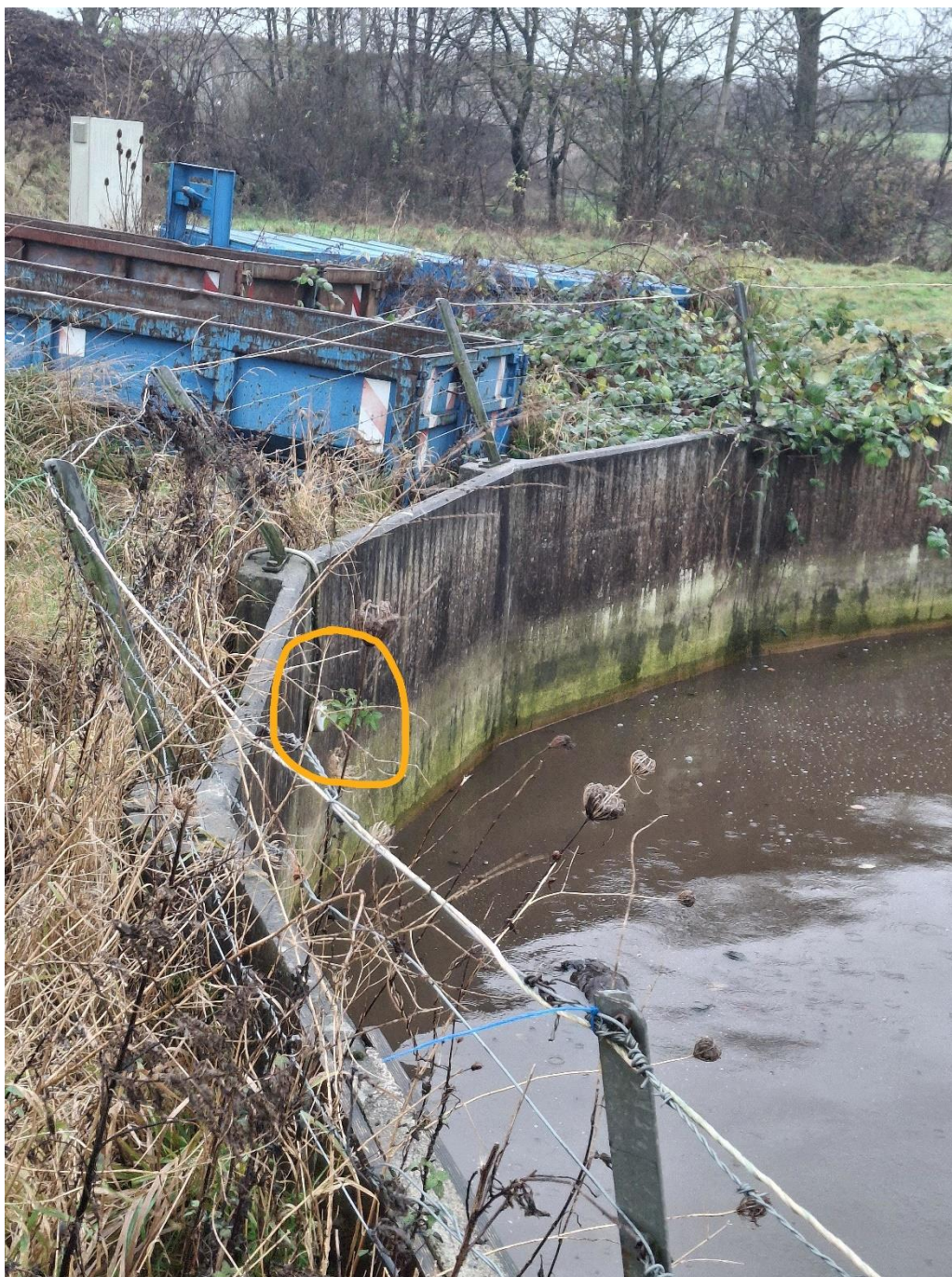
Figur 4. perkolattank ved tilsynet, udstyret med højvandsalarm
