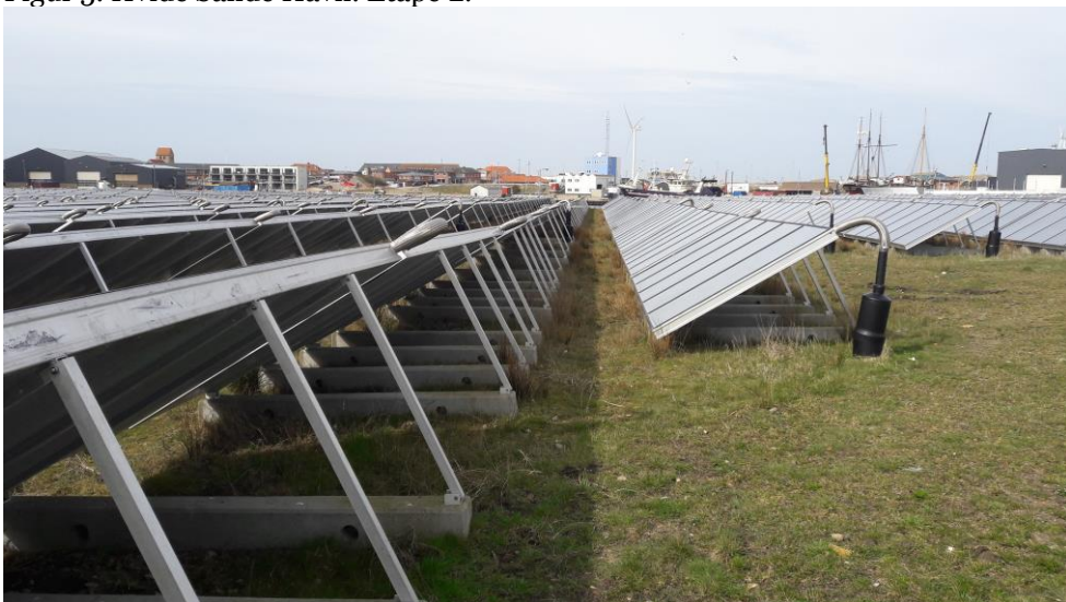
Figur 6. Hvide Sande Havn. Etape 1A er slutfærdig og rummer et solfangeranlæg.
