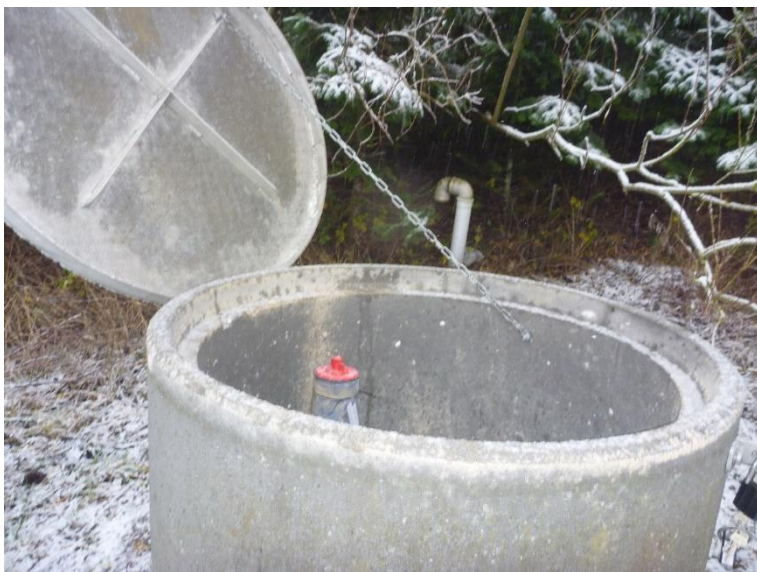
Foto 4: Den ny renoverede boring B2 (DGU nr. 199.937) med låg, lås og prop i forerøret. I baggrunden af billedet ses et udluftningsrør fra deponiets perkolatsystem.
