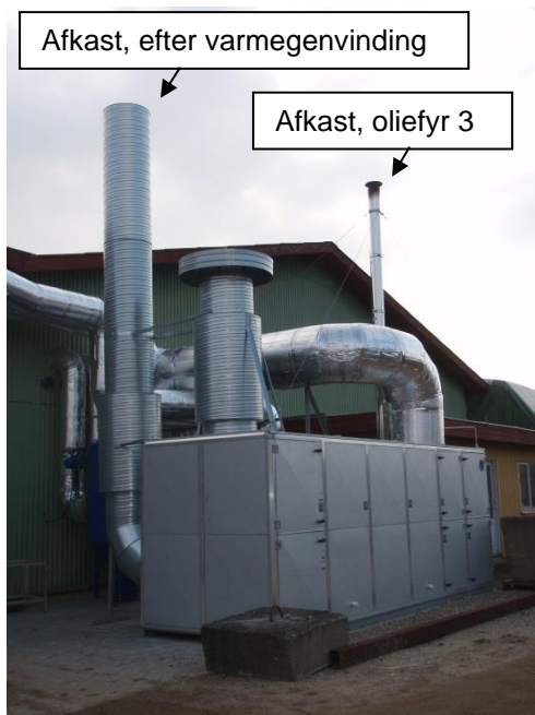
Foto 1: Ventilation og varmegenvinding (fra tilsynsrapporten i 2015)
