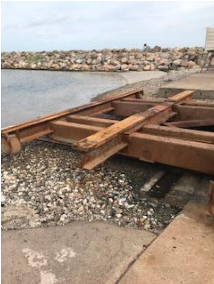
Billede 2. Riste ved beddingsanlægget som opsamler spildevandet
