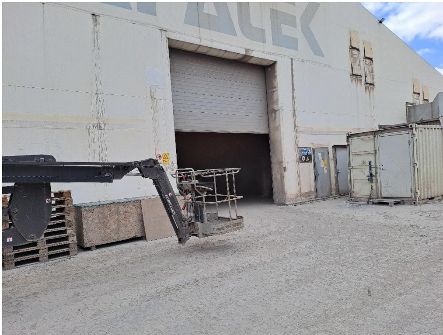
Port ved telthal som ikke kan lukke helt.
