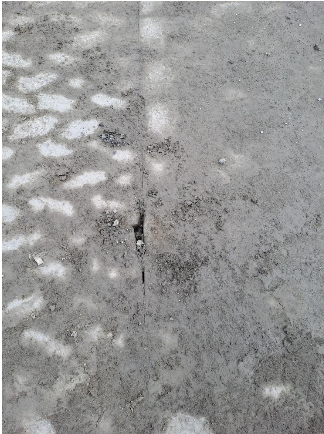
Revne ved de nye SF-sten, som skal udfyldes.
