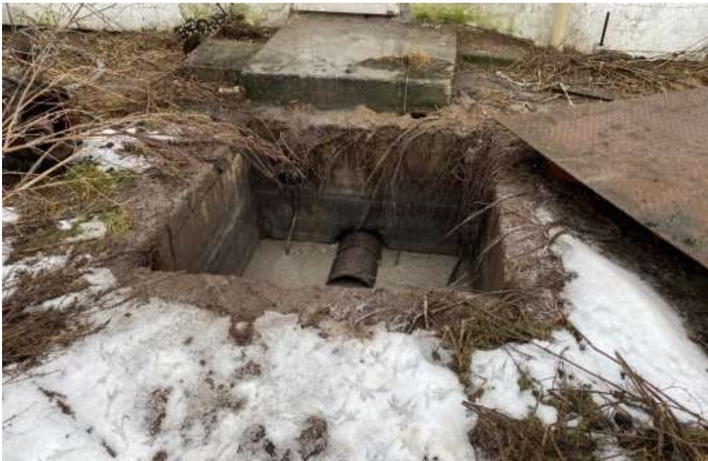
Overløb af gylle på jorden ved tørbrønd.
