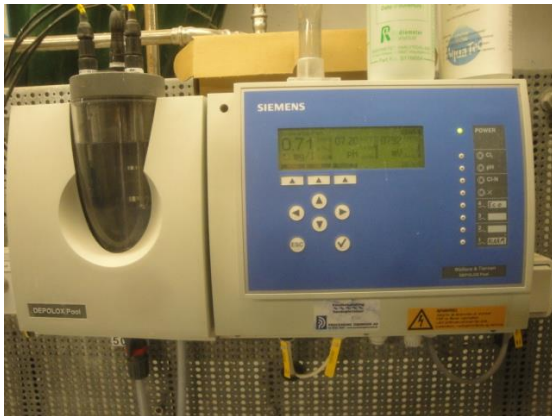
Chlor-/pH-styring fra Siemens.
