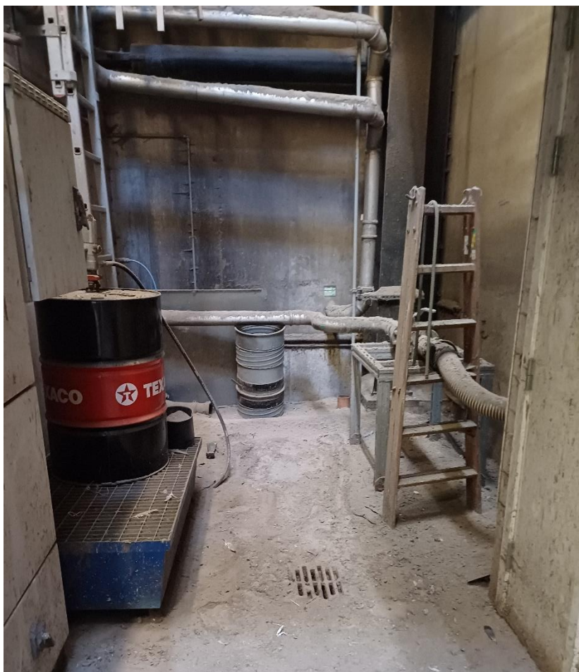
Foto 4. Rum ved virksomhedens slaggecontainer. Der ses store mængder støv efter utæthed på rør.
