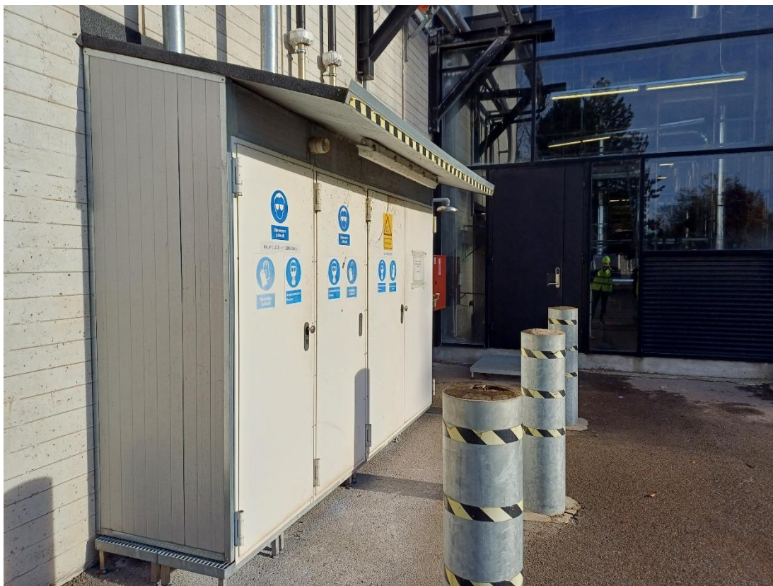
Foto 1. Påfyldningsplads til ammoniak
