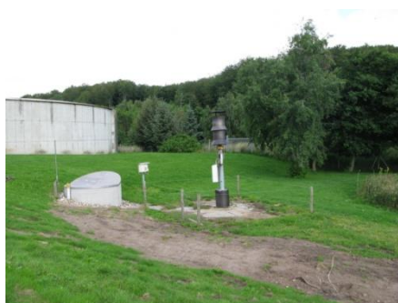
Figur 5: Flare og kondensatbrønd.
