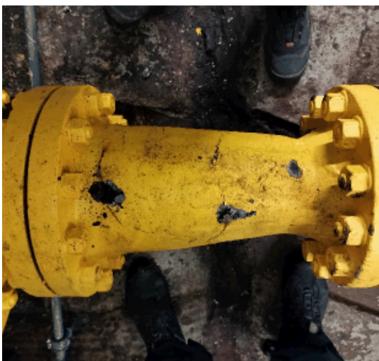
Revnedannelse i rør, der er undersøgt.
