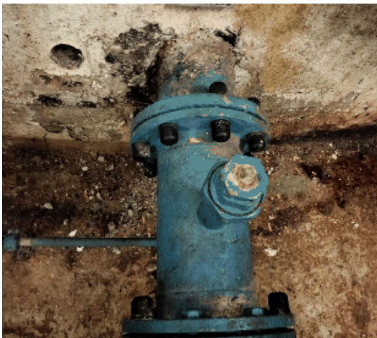
Nedbrudt beton og nedbrudte malede flader.
