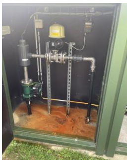
Stoppet afværgeoppumpning, med synlig perkolatoverløb.
