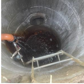
Brønd med overfladevand over slutafdækning, mulighed for prøvetagning.
