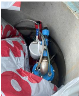
Brønd for afværgeoppumpning, prøvetagning og følere.
