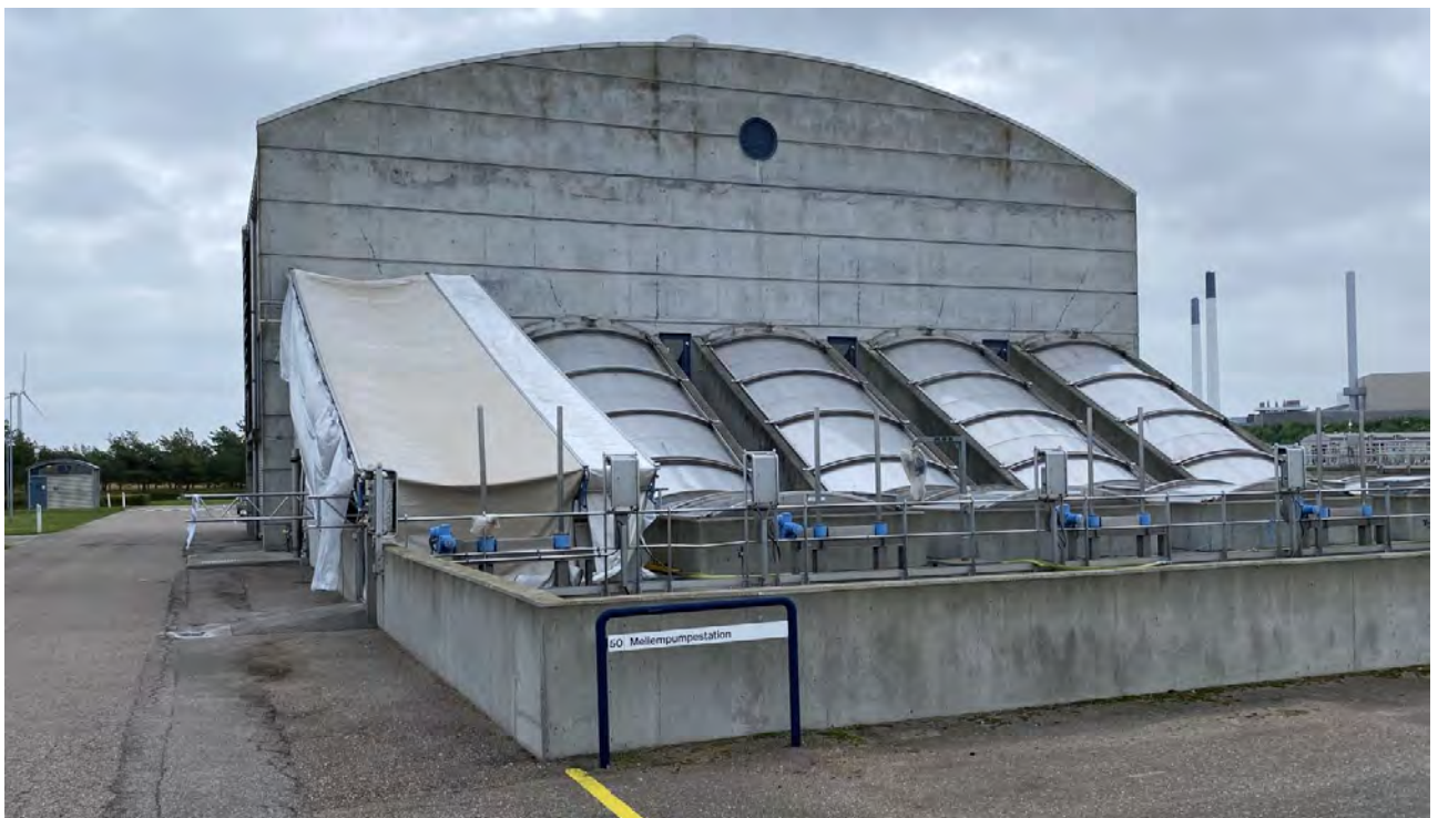
50 Mellempumpestation, snegle dæmpes ekstra.
