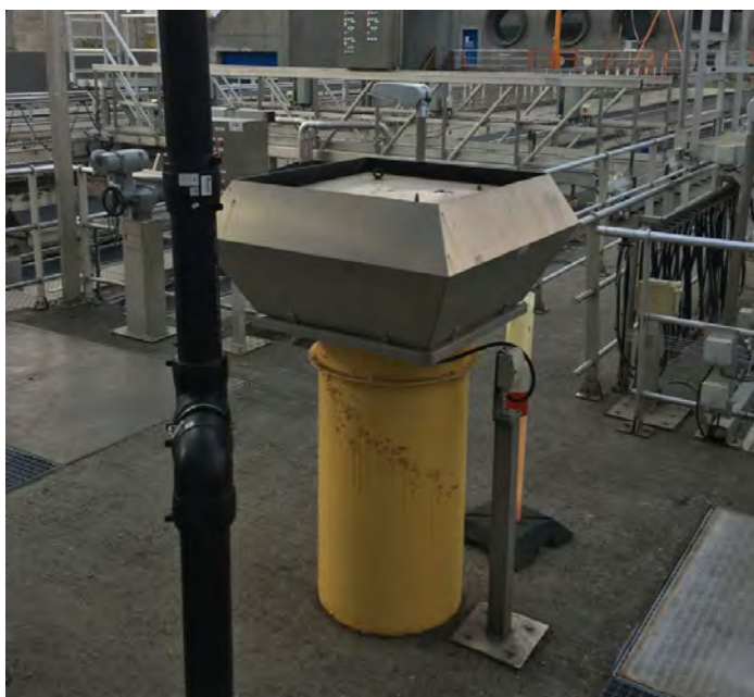
4 Ristebygværk, afkast med motor ved scrubbere.
