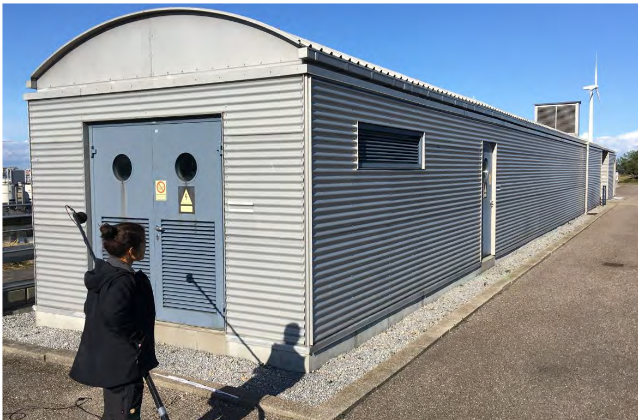
51/53 El-hus, gavljalousi dæmpes 10 dB. Sidejalousi dæmpes 5 dB.
