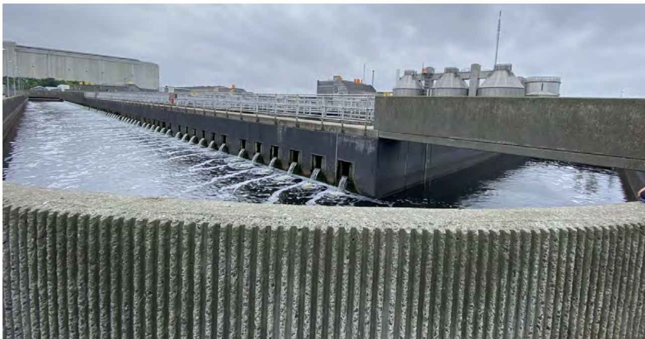
7 Sekundærtanke fraløb, overdækning.
