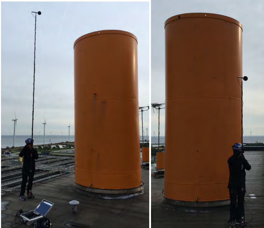
10 Slamafvanding, afkast orange, nordlig og sydlig.
