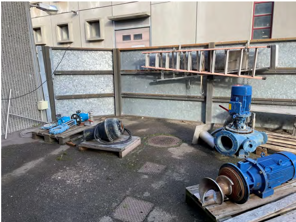
Foto 2: Olieudskiller tilsluttet til værksted kloaksystem (slamforbrændingsanlæg).
