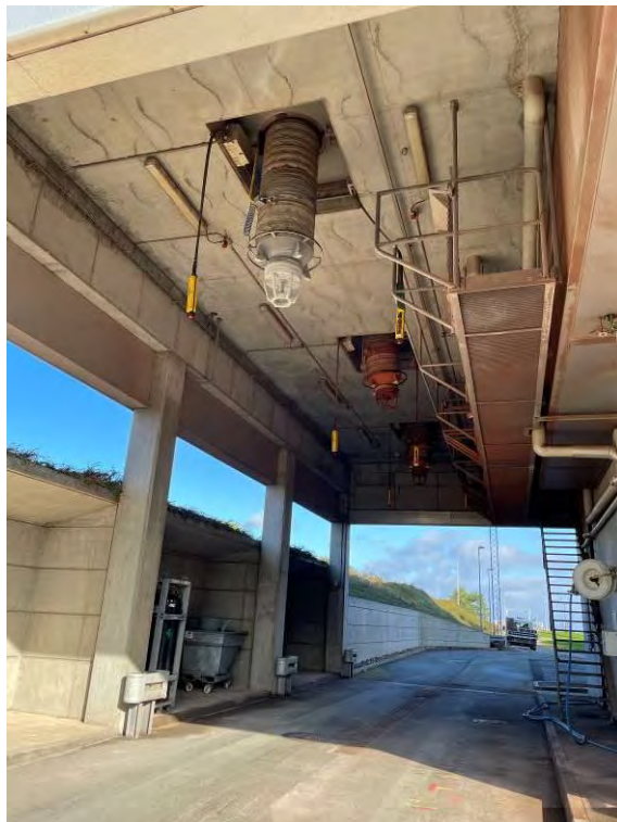
Foto 4: Område som anvendes til at læsse silobilerne med aske eller røggasaffald, der skal sendes til nyttiggørelse (slamforbrændingsanlæg)
