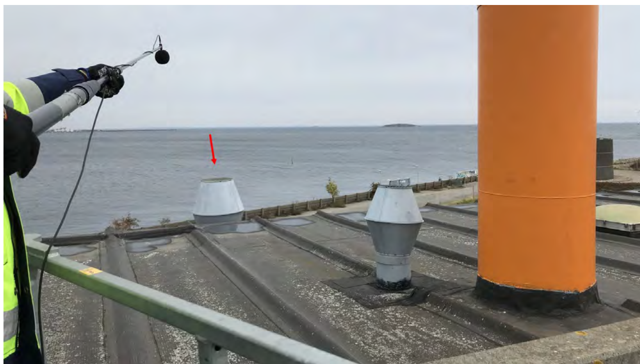
9 Efterpumpestation, jethætte malerværksted, lydæmper på tilgangsrør.
