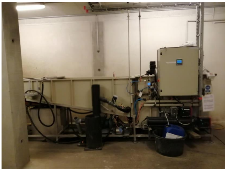
Billede 2 Båndfilter med filterdug til afvanding af slam fra spildevandsrensningsanlæg.
