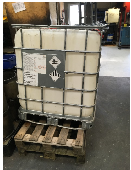
Opbevaring af koldflydeolie, uden spildsikring.
