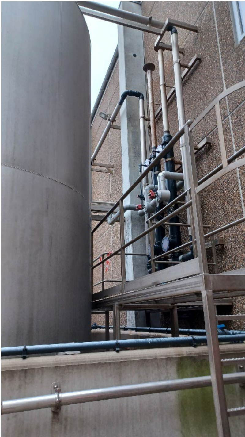
Foto 4. Der er etableret scrubbere på fortrængningsluft fra eddikesyreanhydrid tank og saltsyretank med adgang fra gangbro mellem bygning og tanke.
