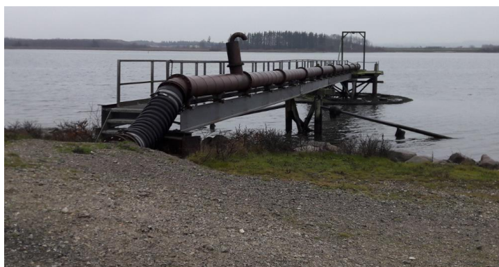
Foto 2. Anlæg til indspuling af sediment fra pram via fast rørledning fra anløbsbro til landfelterne.
