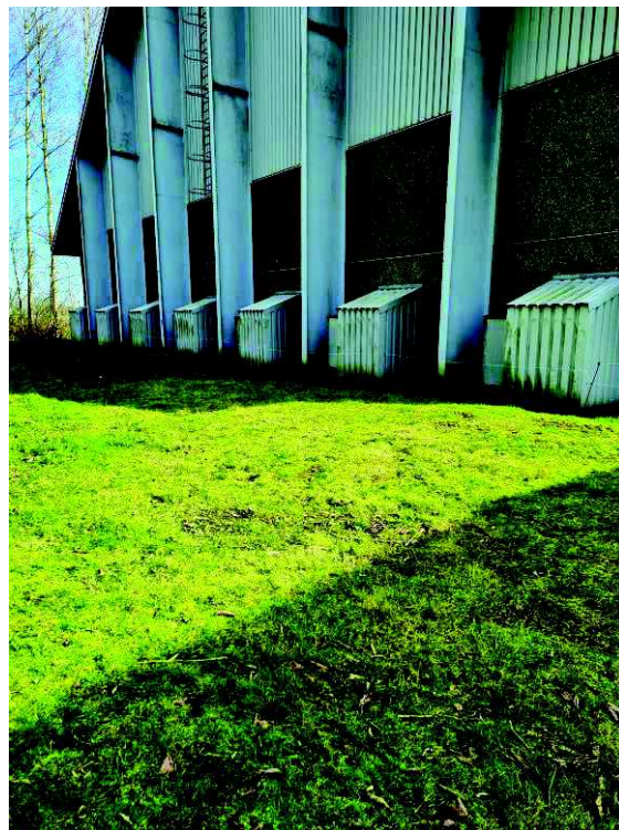
8. Beluftning hal 4, 7 stk.
