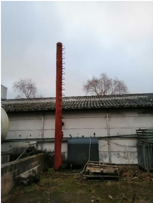
. Billede 4. Afkast fra fyringsanlægget.
