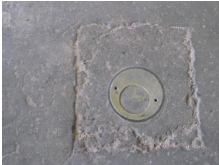
Foto af punktudsug i gulvet, hvor flexslanger kan påmonteres.
