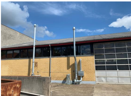
Foto af afkast fra svejseanlæg og båndpudserne. Begge afkast er ført mindst 1 m over tag.
