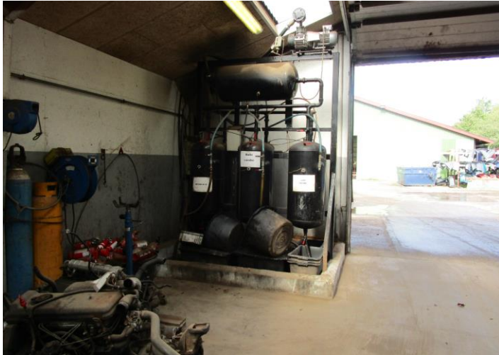
Figur 4 Affaldsrum med opkant og under halvtag. I de viste beholdere er der spildolie mv.
