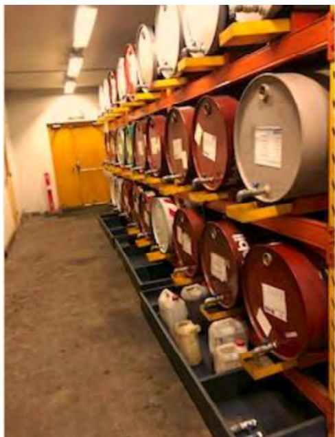
Figur 3: Foto fra smørerummet.
