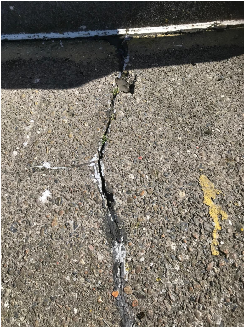
tank 57, revne i tankgårdsbund
