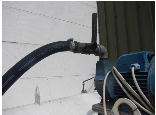
12. Dieseltankanlæg. Der er siden sidste tilsyn monteret klart synlig manuelt betjent stopventil, til sikring mod upåagtet tømning af anlægget ved hævertvirkning (ved skade på slange og pistolhåndtag).
