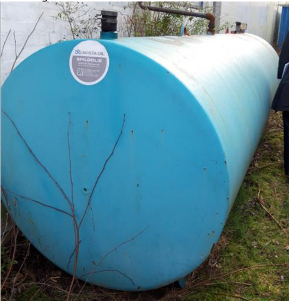
Fotos –gl. 4000 l tank
