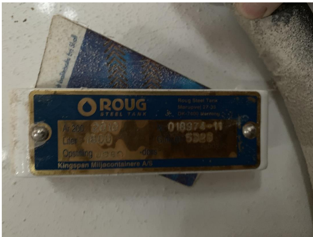
Mærkeplade 1800 l tank, årgang 2010. Reservetank til fyringsolie.
