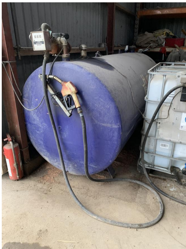
Tank til traktordiesel
