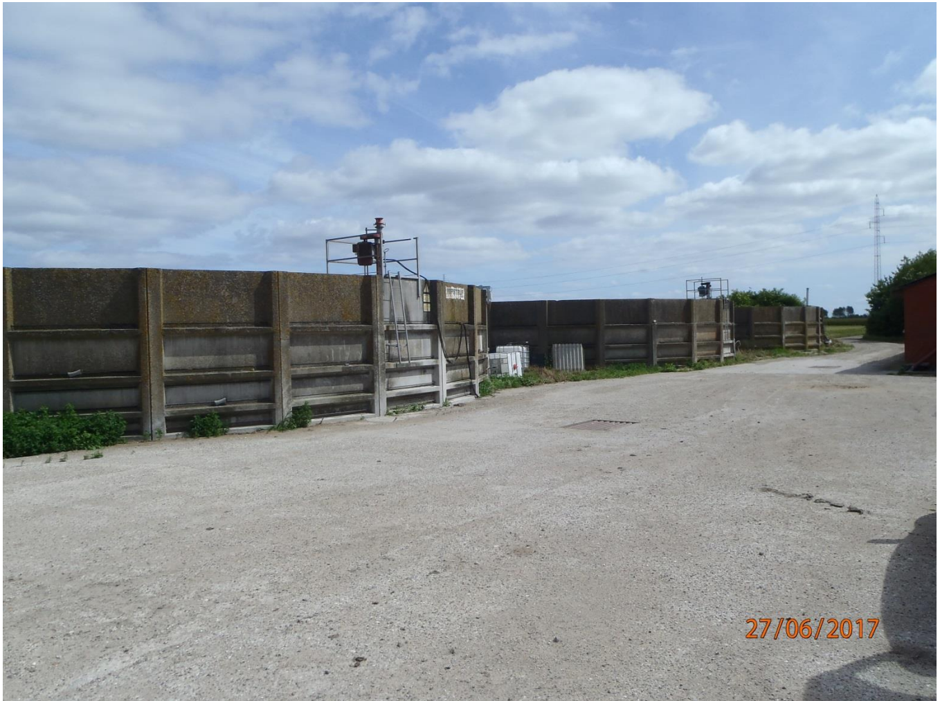
Billedet viser de tre gyllebeholdere på hhv. 1530m 3 , 1060m 3 og 1060m 3
