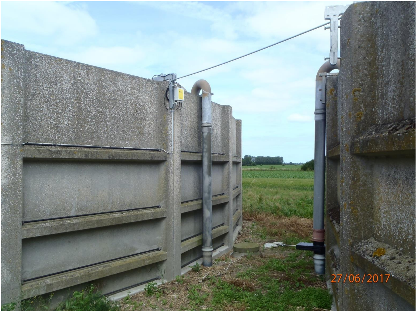
Billedet viser beholderalarmer sammenkoblet på de to beholdere på 1060m 3
