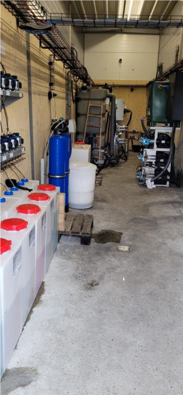
Teknikrummet (beholdere til vaskekemi ses forrest til venstre).
