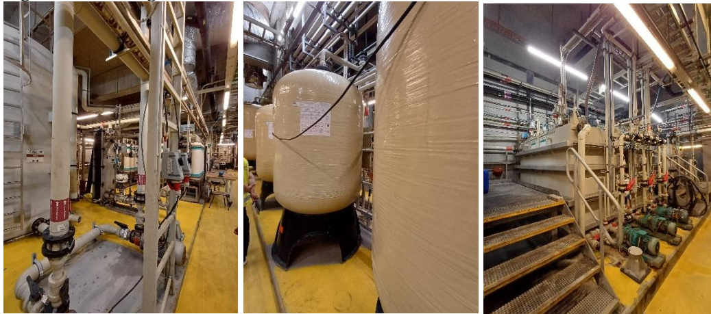
Foto fra spildevandsrenseanlægget for procesvand og kondensatvand.
