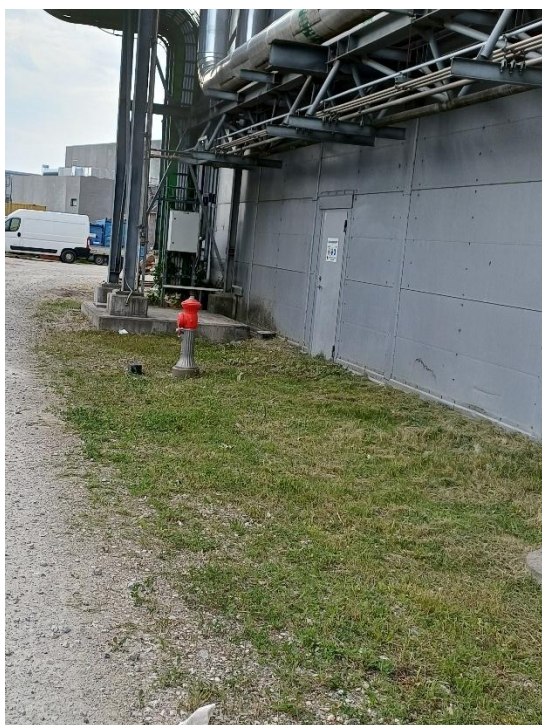
Spildet ved oliehanerne var bag betonstøtten.
