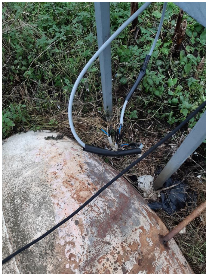
Billede 4 Overklippede ledninger til relæet, der styrer strømmen ved tilsynet d. 6. december 2023.
