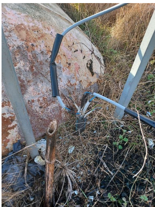
Billede 6 Overklippede ledninger ved tilsyn d. 3. januar 2023
