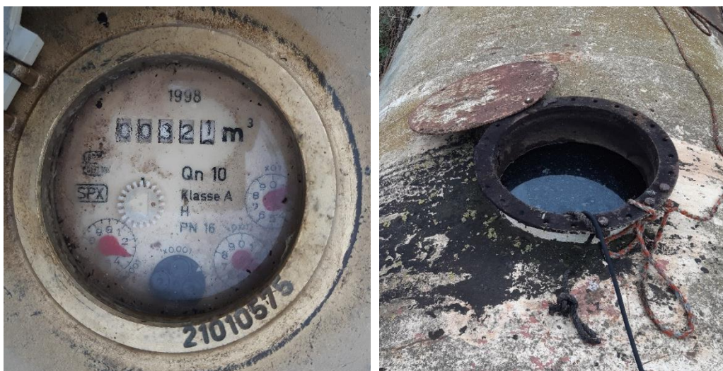
Billede 3 Måler og vandstand i tank ved tilsyn d. 6. december 2022
